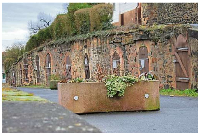
Die Landesgartenschau könnte die Chance sein, die Felsenkeller in Dauernheim zu sanieren. Foto: Woitas/Archiv
